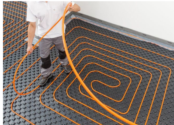
Suelo radiante hidráulico
